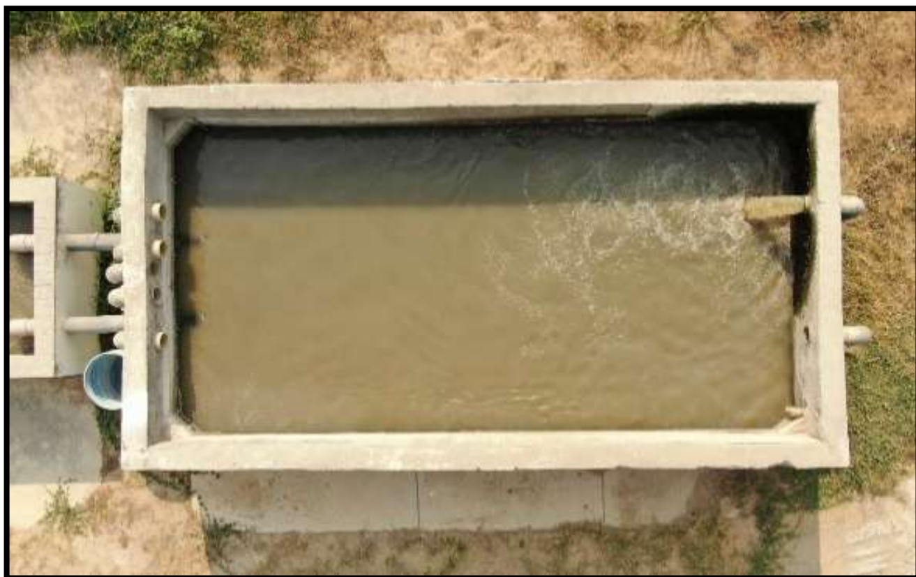
Figura 4. Desarenador de la PTAR.
